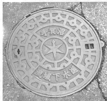
写真-1 手賀沼流域下水道の人孔鉄蓋
