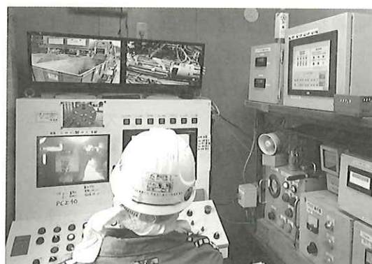
写真-2 掘進運転室
