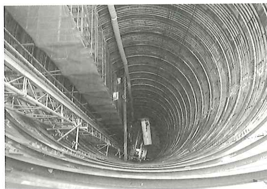
写真ー4 立坑内エレベータ
